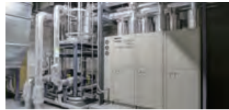
地中熱ヒートポンプシステム
